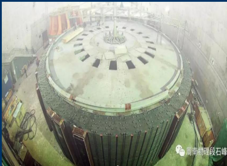
三峡电站一台发电机的转子
